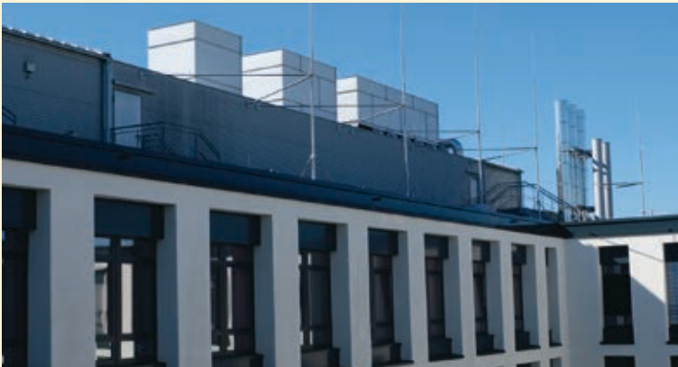
Abb. 3 Kühlturm und Abluftanlagen der Energiezentrale beanspruchen etwa 54 m 2 an Aufstellfläche auf dem Dach der Klinik.
