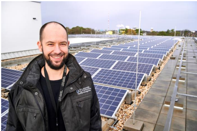
Klimamanager Marcel Malucha vor der Photovoltaikanlage auf dem Dach des Gebäudes der Neurologie, Psychiatrie und Psychosomatik (NPP) am Universitätsklinikum Bonn (UKB). © Universitätsklinikum Bonn (UKB)/J.F. Saba
